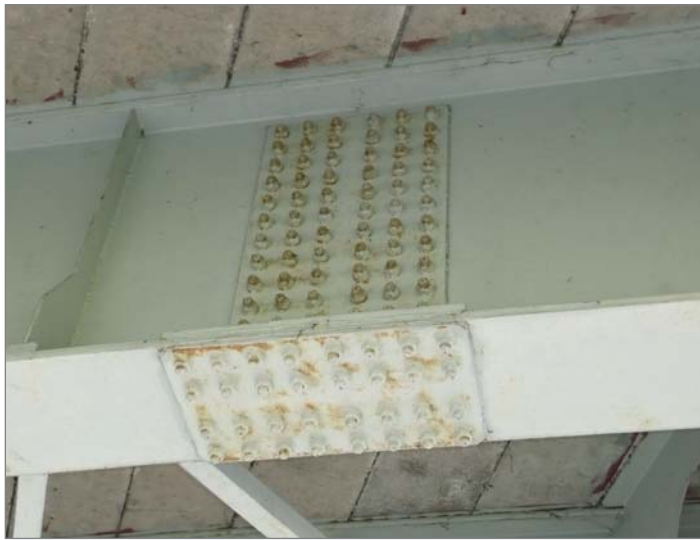
Rys. 2.69. Przykład zjawisk korozyjnych połączenia na śruby sprężające – widoczne ogniska korozji zarówno samych śrub i nakrętek, jak również nakładek
